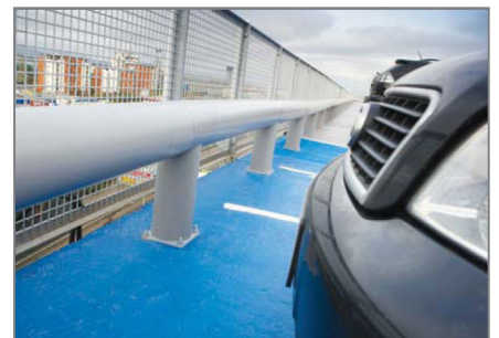
Car Park Barrier (주차장 보호 안전장벽)
